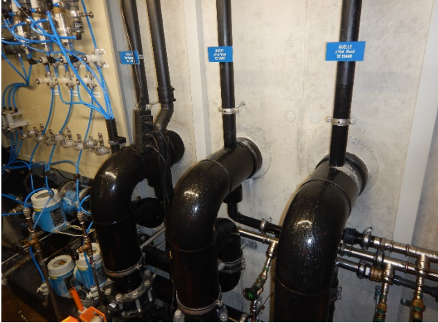
Pumpwerk z'Hof, WV Oberdorf
