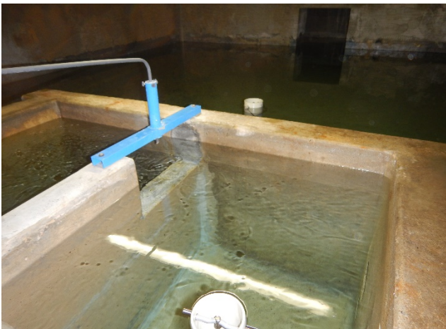
Pumpwerk z'Hof, WV Oberdorf
