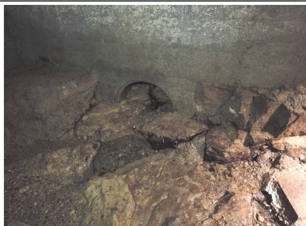
Quelle z'Hof Niederdorf – Einlauf E
