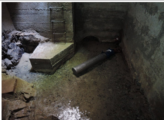
Quelle z'Hof Niederdorf – Einläufe F und G, Ableitung
