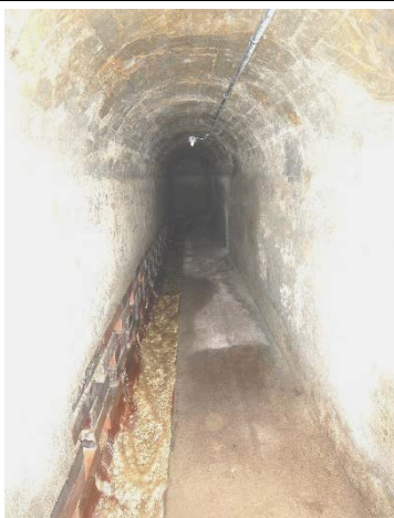
Quelle z'Hof Oberdorf Nord (Ost) - Sickerstollen
