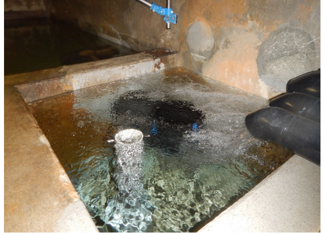
Pumpwerk z'Hof, WV Oberdorf, Quellzuläufe
