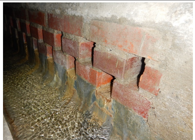
Quelle z'Hof Oberdorf West – Backsteinlage auf der Nordseite mit eintretendem Wasser
